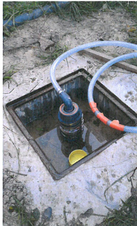
Puits équipé et raccordé
